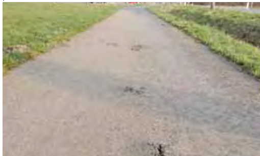
Neuer Radweg an der Hohenholterstraße: schon beschädigt.
